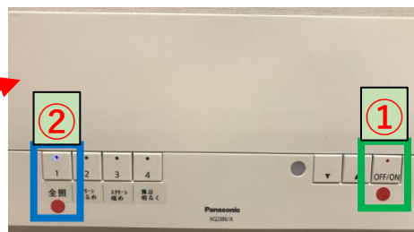
FLコントローラー親機
