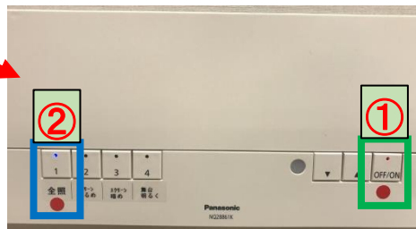
FLコントローラー親機
